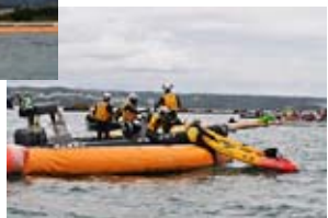
↑強行される護岸工事 →カヌー隊に襲いかかる海上保安庁
